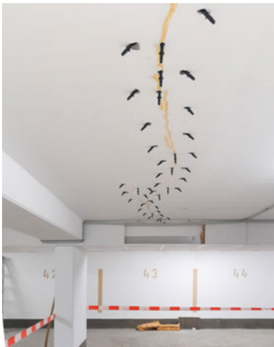
Rissverpressung in der Zwischendecke einer Tiefgarage
